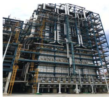
图 2 乙烯裂解炉烟气脱硝装置
