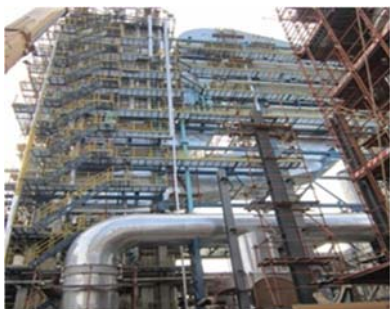
图 1 催化裂化烟气脱硝装置
